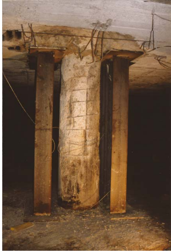
Figura 2: Grado de deterioro del pilar más afectado por el incendio
